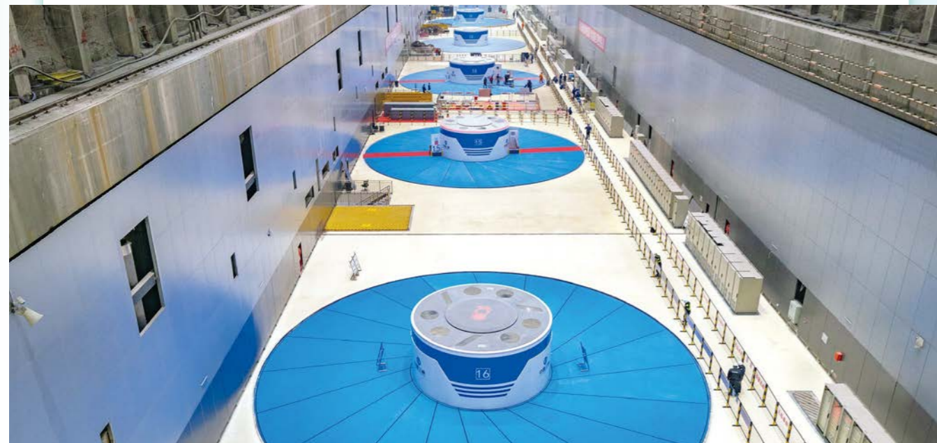
白鹤滩水电站右岸地下电站主厂房
